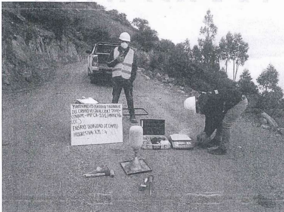
FOTOGRAFÍA N°12. Ensayo N°12 de Densidad de Suelo en Campo (Método del cono de arena) en la progresiva Km 13+500.
