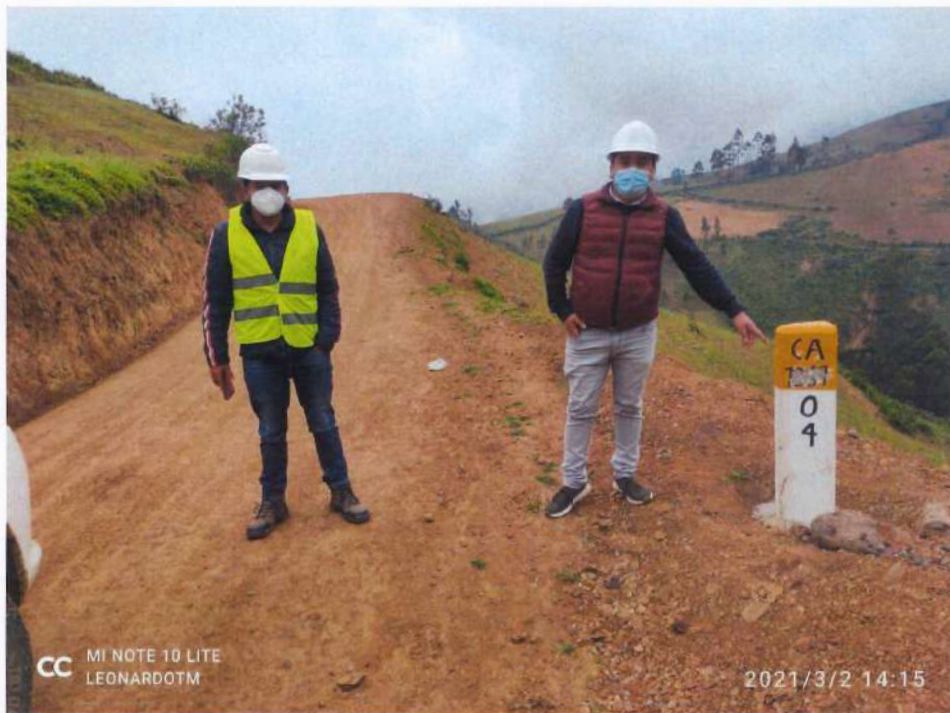
Fotografía 134. Verificación de los daños ocasionados al hito kilométrico 04 por personas ajenas a la obra .
