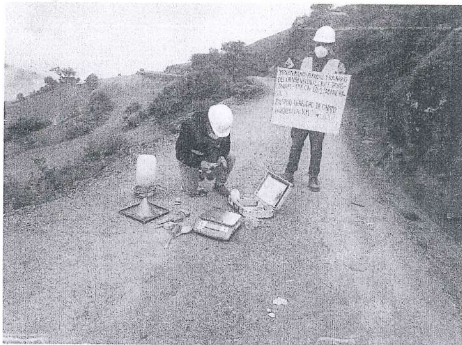
FOTOGRAFÍA N°8. Ensayo N°08 de Densidad de Suelo en Campo (Método del cono de arena) en la progresiva Km 12+500.
