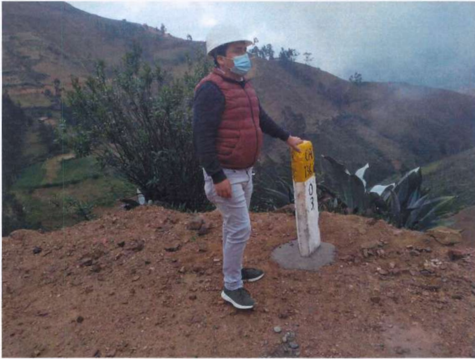
Fotografía 133. Verificación de los daños ocasionados al hito kilométrico 03 por personas ajenas a la obra .
