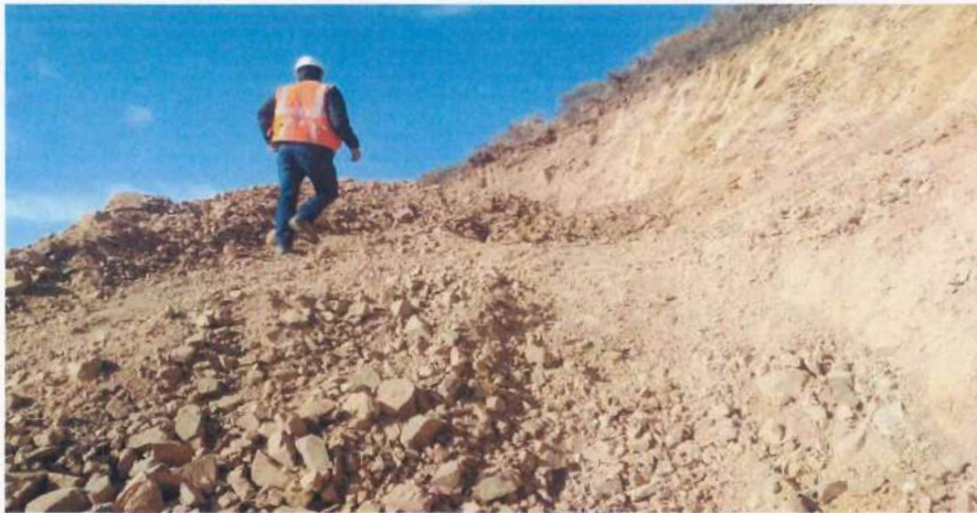
Fotografía 13: Ing. Residente verificando la extracción de material en cantera del señor Santos Medina Ubicada Progresiva KM 5+354.72 en las coordenadas: 735380.92E 9186457.01N.
